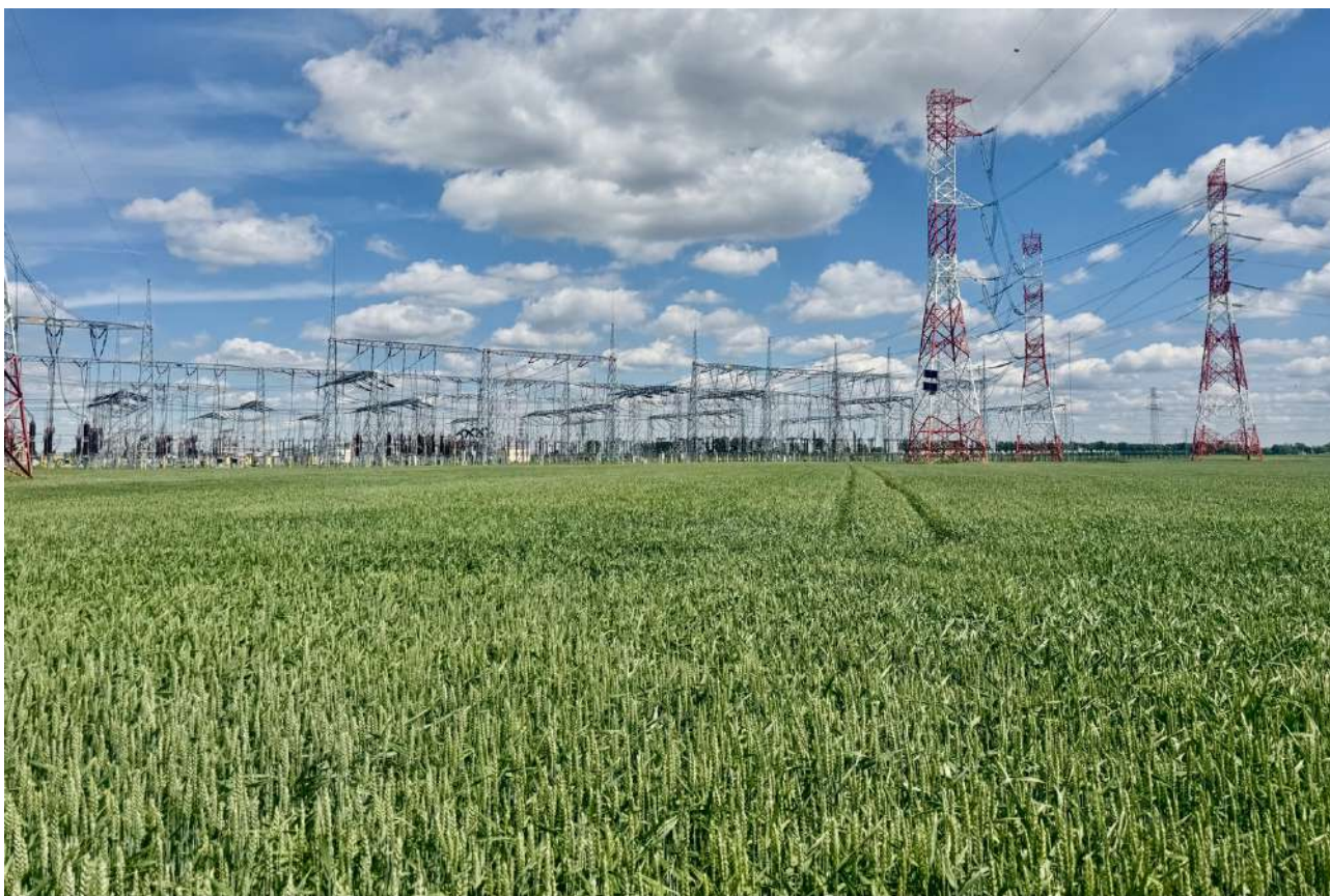
Fot. 4. Widok na GPZ Plewiska z drogi w sąsiedztwie działek objętych wnioskiem. Zdjęcie 04.06.2026 r.
